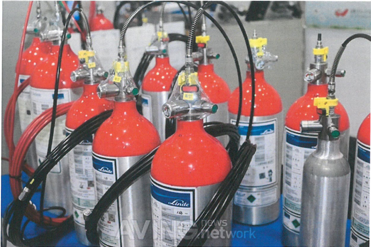
(사진: 자동소화장치는 화재발생 시 약 15초 이내에 화재진압이 완료된다)
